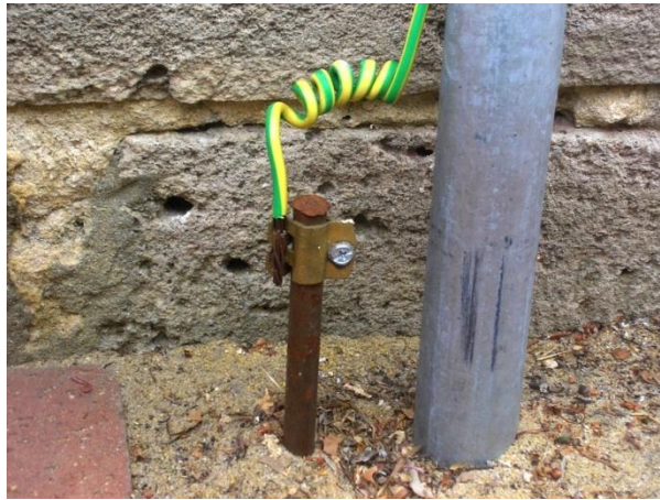
Усі з'єднання громовідводу необхідно періодично перевіряти
